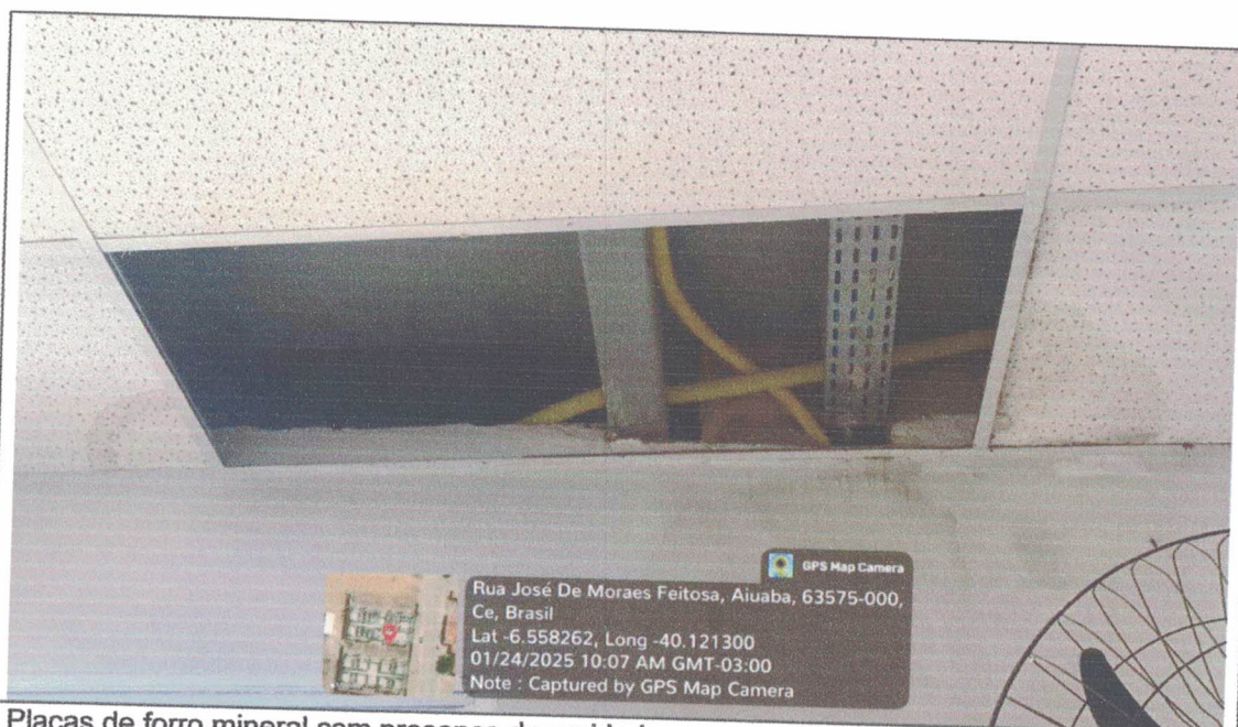
Placas de forro mineral com presença de umidade, manchas e em deterioração no CEI Professora Sirlene Maria do Nascimento
