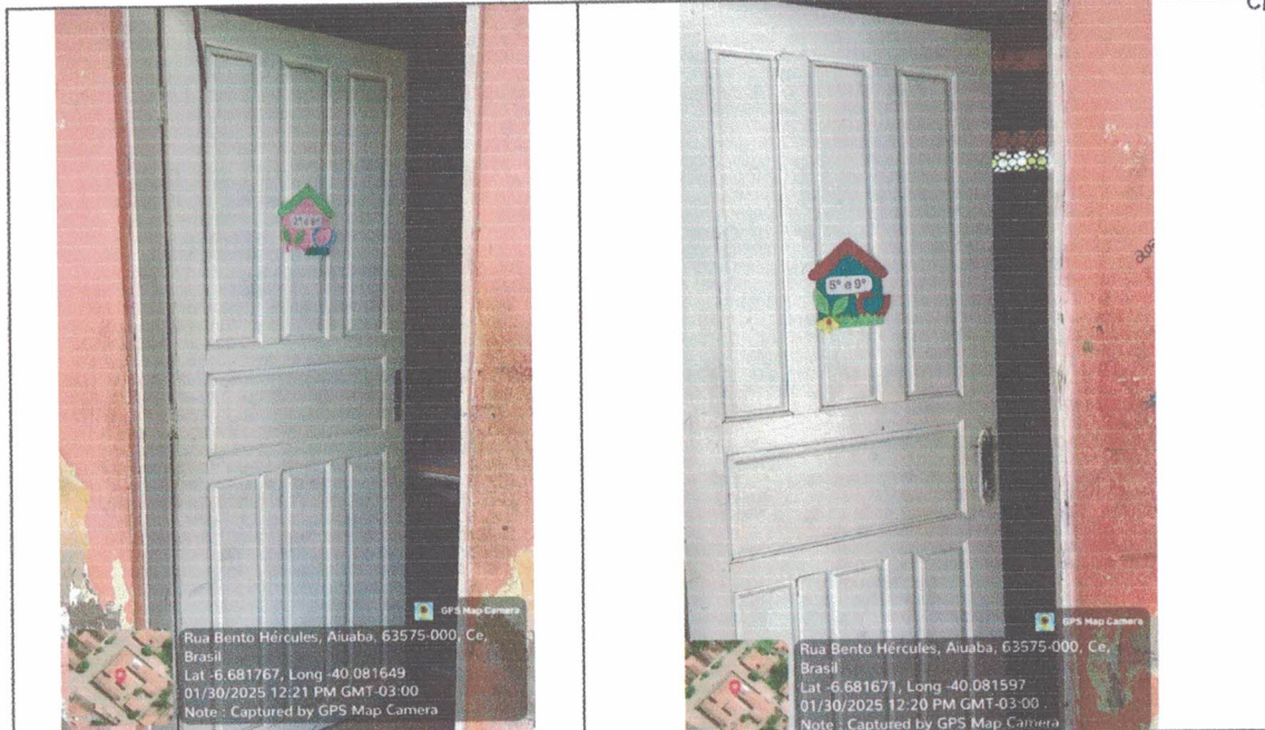
Portas com fechaduras quebradas na EEIF Edmundo Braga
