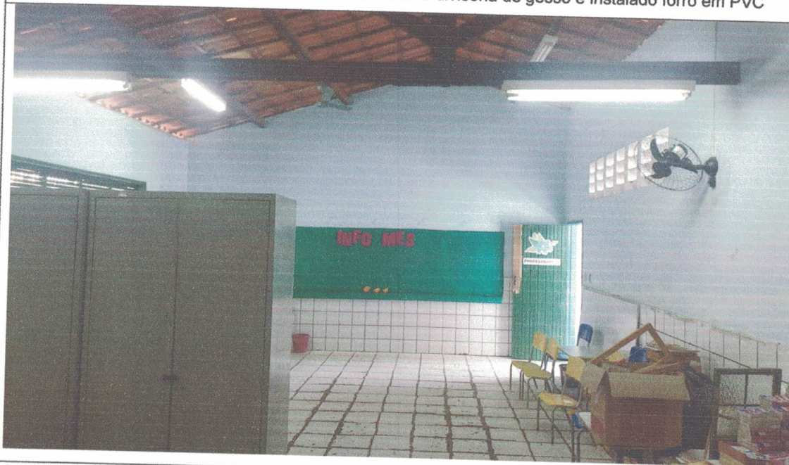
Sala dos Professores II – Local em que será construído divisória de gesso e instalado forro em PVC
