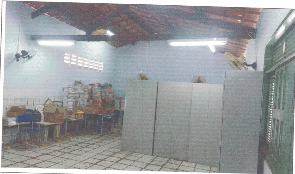
Sala dos Professores II – Local em que será construído divisória de gesso e instalado forro em PVC
