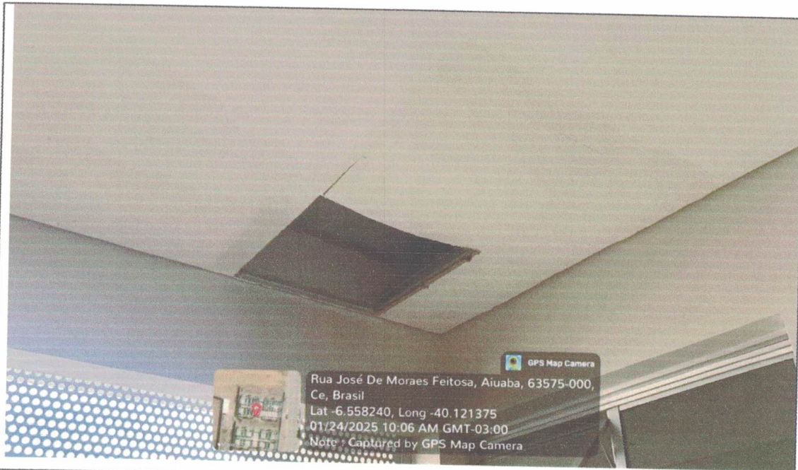
Forro em gesso acartonado em deterioração no CEI Professora Sirlene Maria do Nascimento
