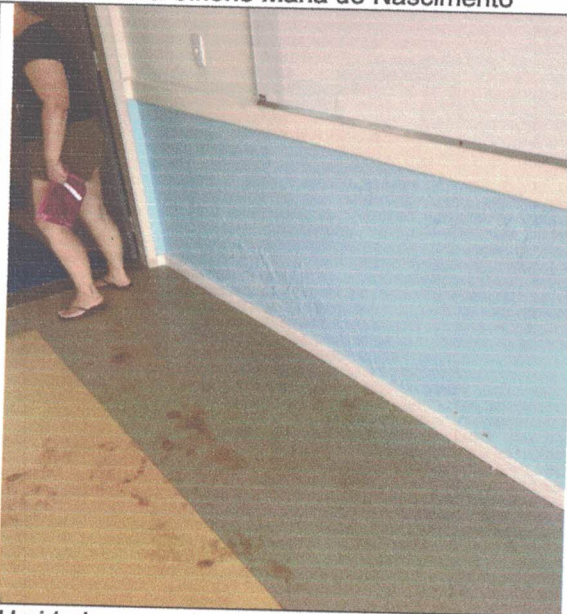
Umidade ascendente em paredes
