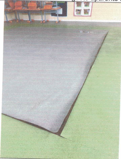
Piso vinílico apresentando deslocamento causado por acúmulo de água oriundo de infiltrações
