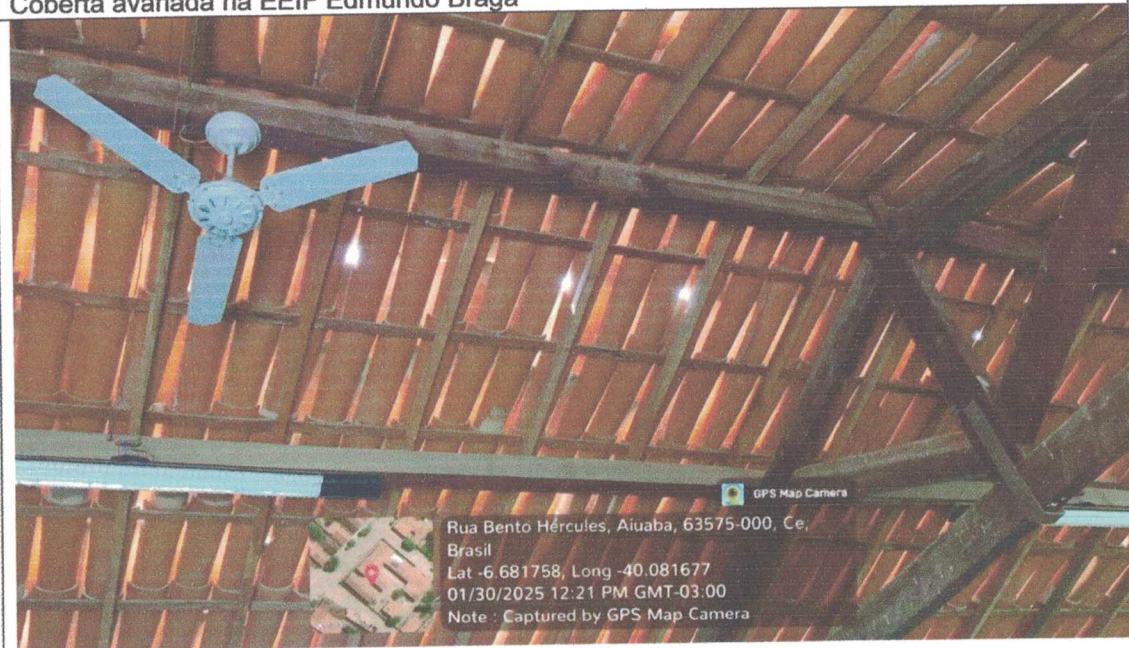
Coberta avariada na EEIF Edmundo Braga
