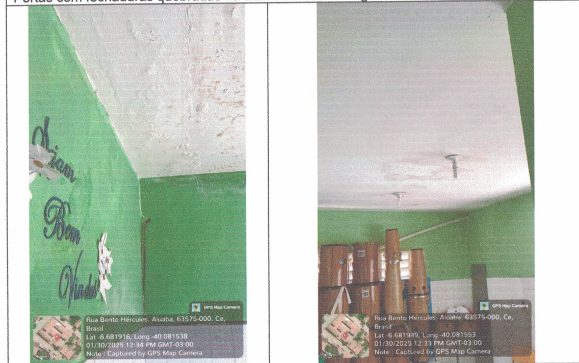
Umidade aparente em parede e teto ocasionada por infiltração em cobertura na EEIF Edmundo Braga
