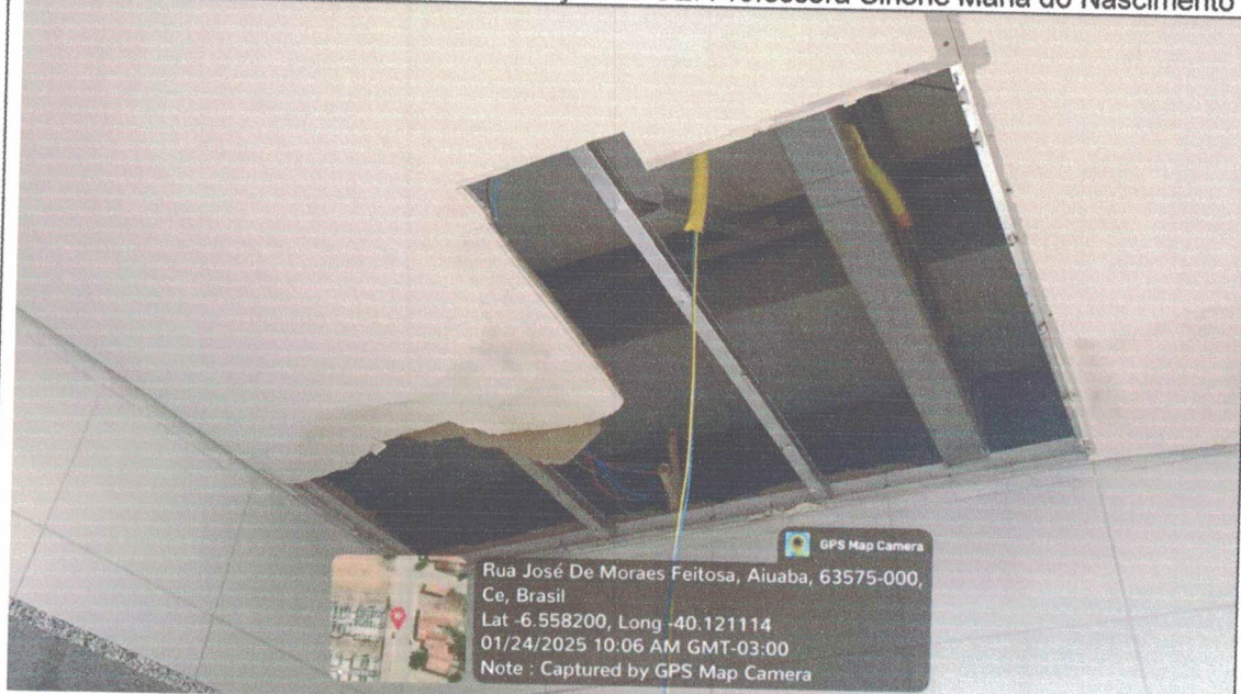
Forro em gesso acartonado em deterioração no CEI Professora Sirlene Maria do Nascimento
