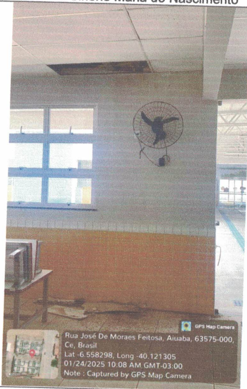
Placas de forro mineral com presença de umidade, manchas e em deterioração no CEI Professora Sirlene Maria do Nascimento
